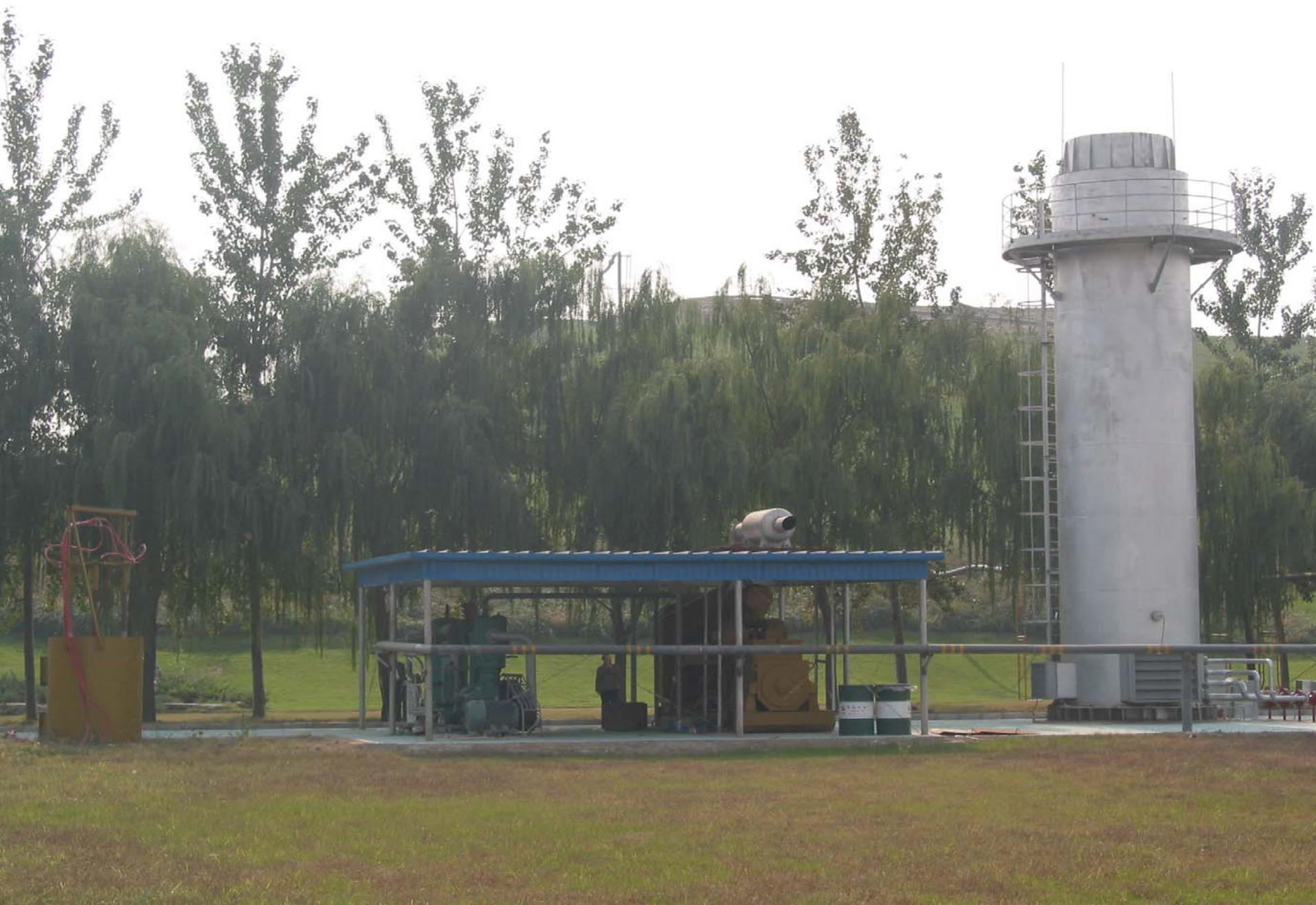
中科院填埋气焚烧火炬和发电机组示范工程
