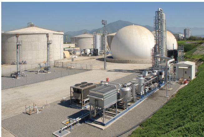
Digestores anaeróbicos e instalaciones de tratamiento de biogás, PTAR La Farfana (Santiago, Chile)
