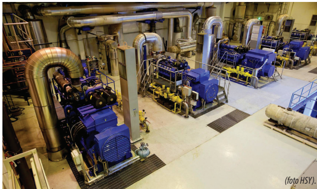
Central de generación combinada de calor y electricidad, PTAR Viikinmäki (Helsinki, Finlandia)
