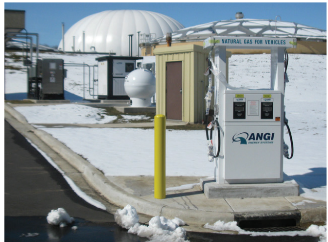
Biogás de aguas residuales para un proyecto de combustible de GNC para vehículos, PTAR Janesville (Janesville, Wisconsin, EE.UU.)
