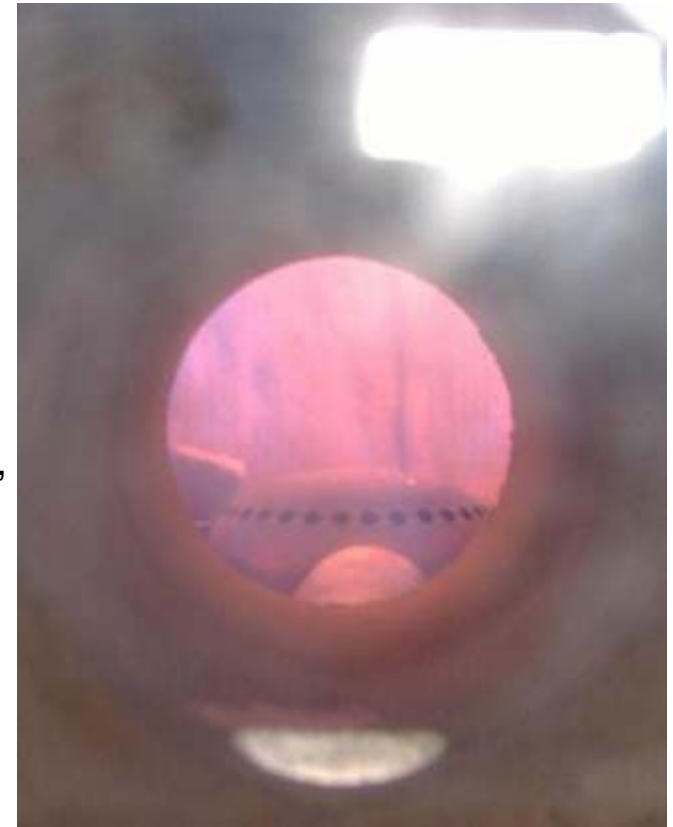
Quemadores Planta Biogás KDM (Julio, 2010)
