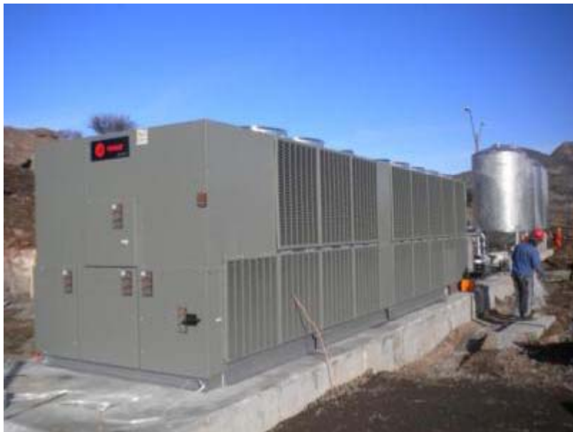
Planta de Acondicionamiento y Filtrado de Biogás
