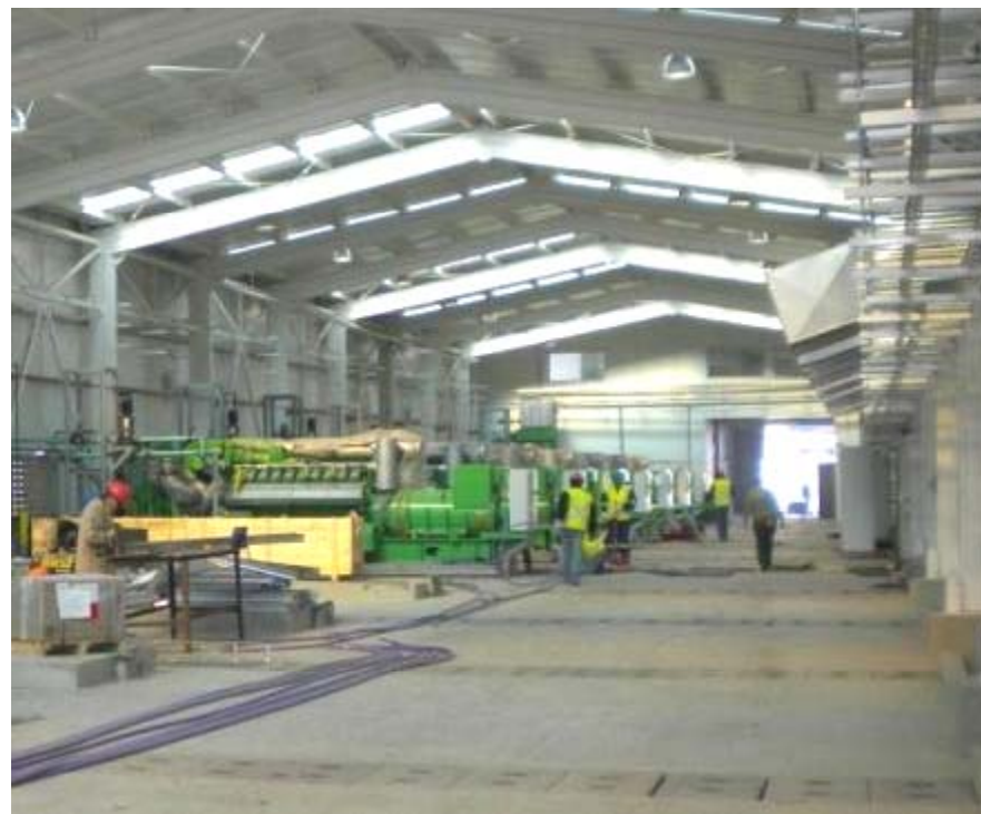
Montajes Interior Nave de Generación
