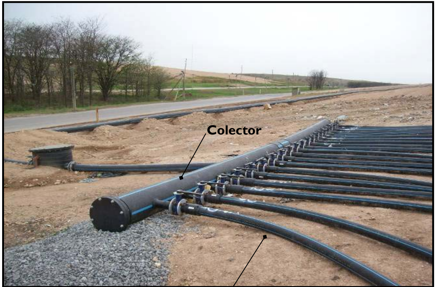
Tuberías laterales provenientes de los pozos de extracción
