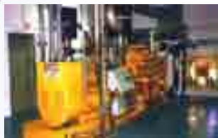
Motor de Combustión Interna (varia desde 100 kW a 3 MW)
