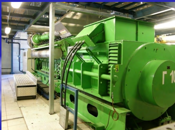
Фрагмент машинного зала с установленными в нем газопоршневыми установками
