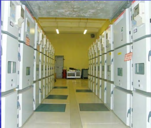
Фрагмент электрощитового зала
