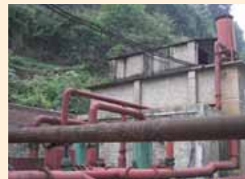
Figura 3: Estación de bombeo en la zona de minería de carbón de Songzao
