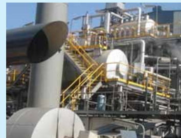
Figura 2: La planta de energía de VAM en la mina West Cliff Colliery de BHP Billiton en Australia
