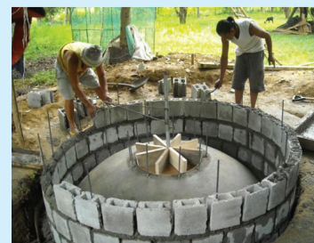
Construction d'un digesteur à dôme fixe à cheminée à Nueva Vizcaya, aux Philippines
