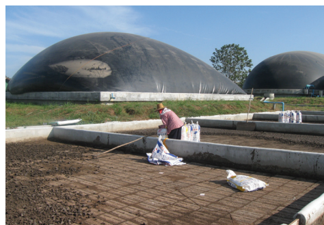
Digesteur anaérobie des Solides Pit sec en avant-plan (Thaïlande)
