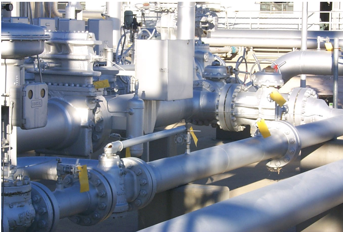
Figure 8: Fotografía que muestra fugas marcadas en equipo en una instalación de procesamiento de gas.
