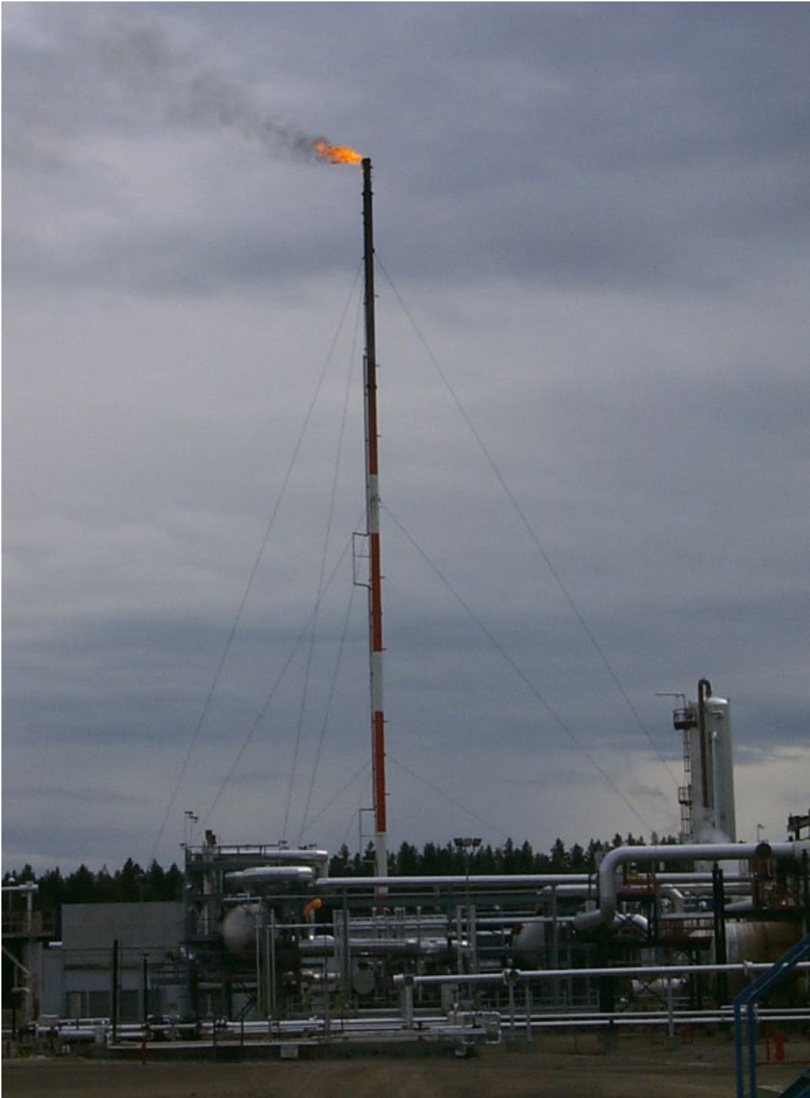
Figura 9: Fotografía de un quemador típico en una instalación de producción de petróleo y gas.
