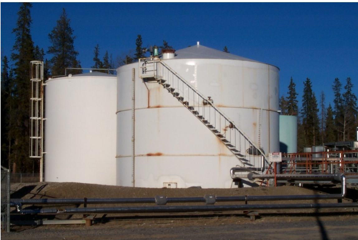
Figura 7: Fotografía de tanques de hidrocarburos y de agua de formación en una instalación de producción.
