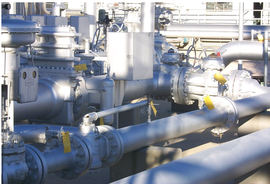
Рисунок 8: Фотография с помеченными неорганизованными утечками из установок на газоперерабатывающем заводе.
