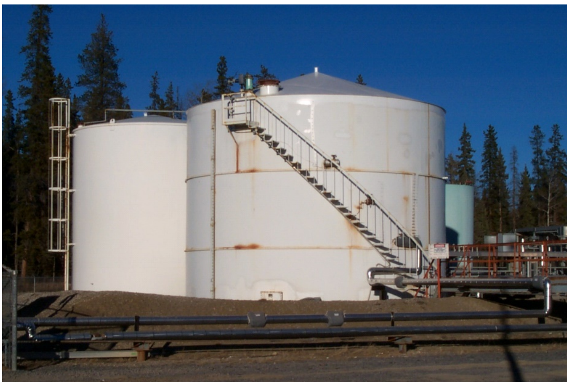
Рисунок 7: Фотография резервуаров для жидких углеводородов и добытой воды на объекте нефтедобычи.
